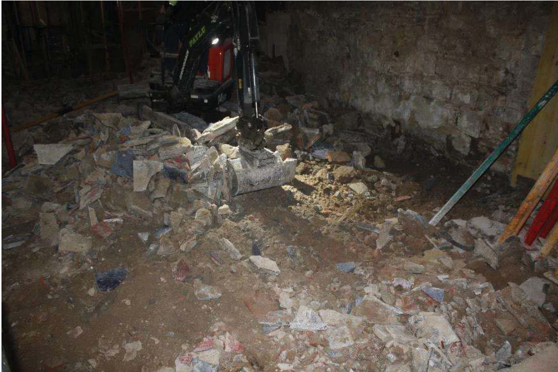
Rebaix mecànic de les pavimentacions i anivellacions contemporànies.
